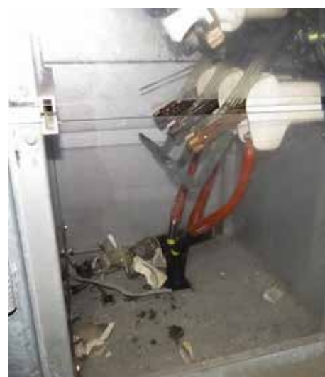
Havari af højspændingsbryder.
