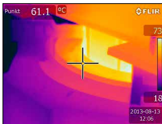
Termografi foto af lavspændingspole på tørtransformer.
