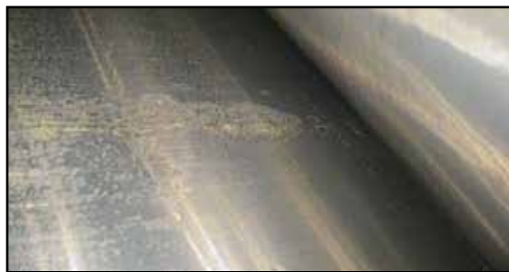
Tidlig skade: Begyndende afskalning på inderringen i et gearleje.
