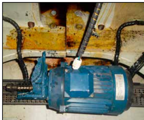
Løsrevet krøjemotor på grund af revnet krøjegear.
