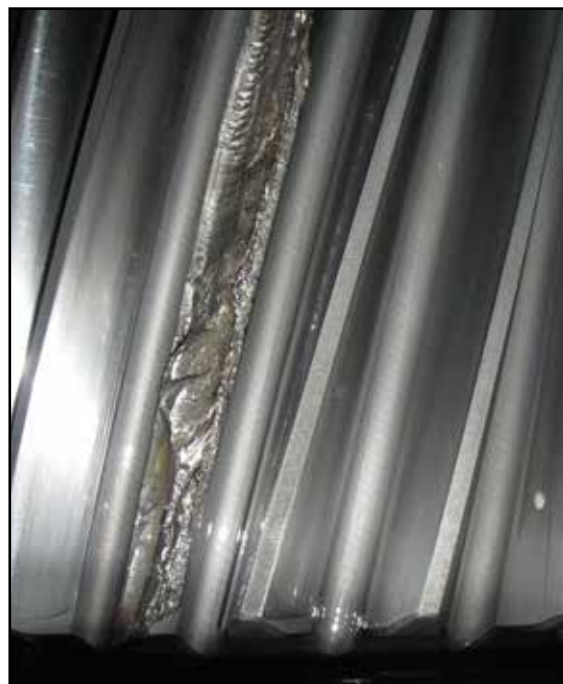
Knækket tandhjul i gear.
